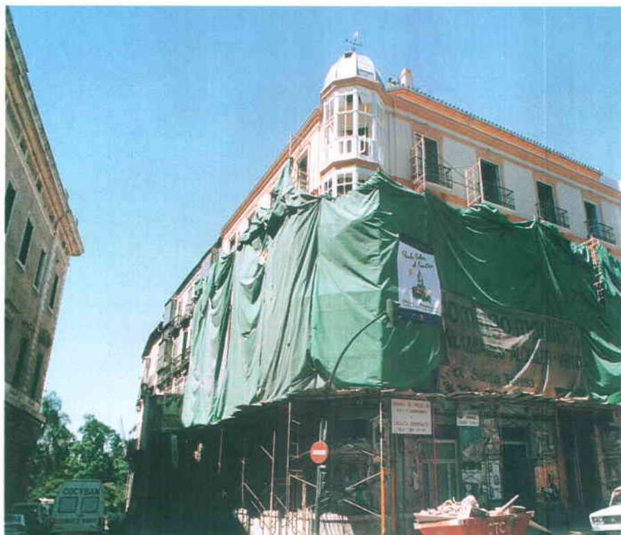
Obras al amparo del subprograma de rehabilitación de fachadas de URBAN en la ciudad de Málaga.
